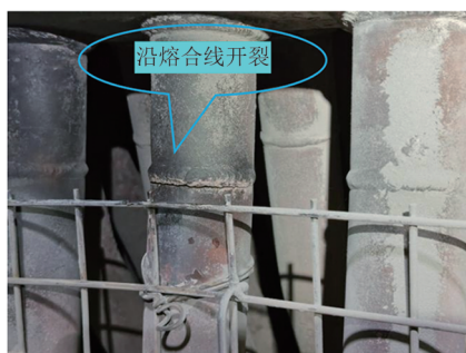
图2 低温再热器管泄漏整体宏观形貌
