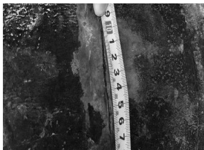
图3 环焊缝开裂宏观形貌
