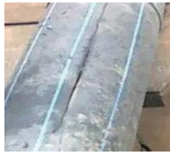
图6 管体轴向裂纹
