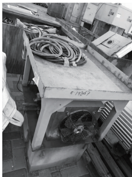
图 2 坡口机配套液压泵站
